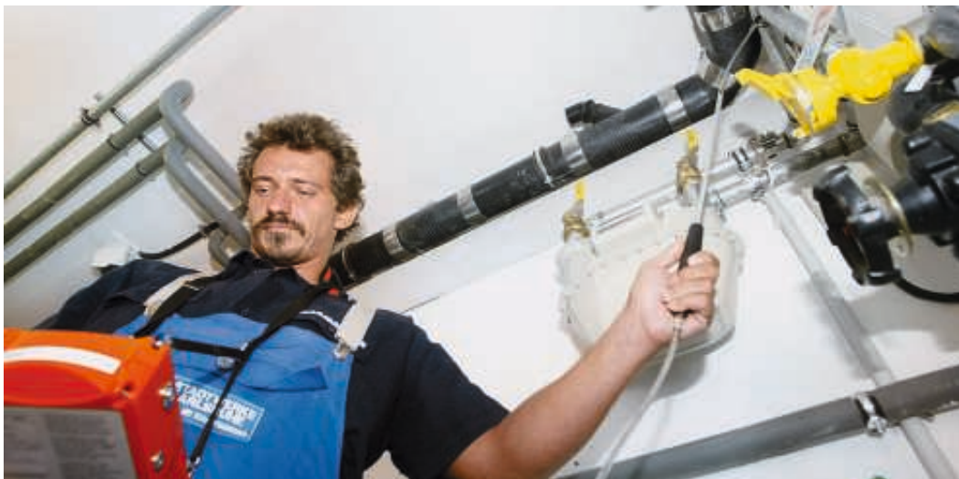
Gut gewartet arbeitet die Heizanlage umwelt-schonend und sicher
