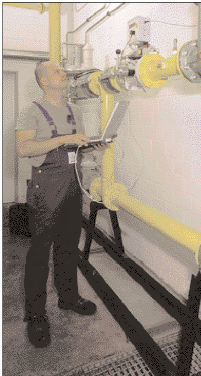
Diese Gasübergabestation versorgt ein Bocholter Großunternehmen für Backspezialitäten.
