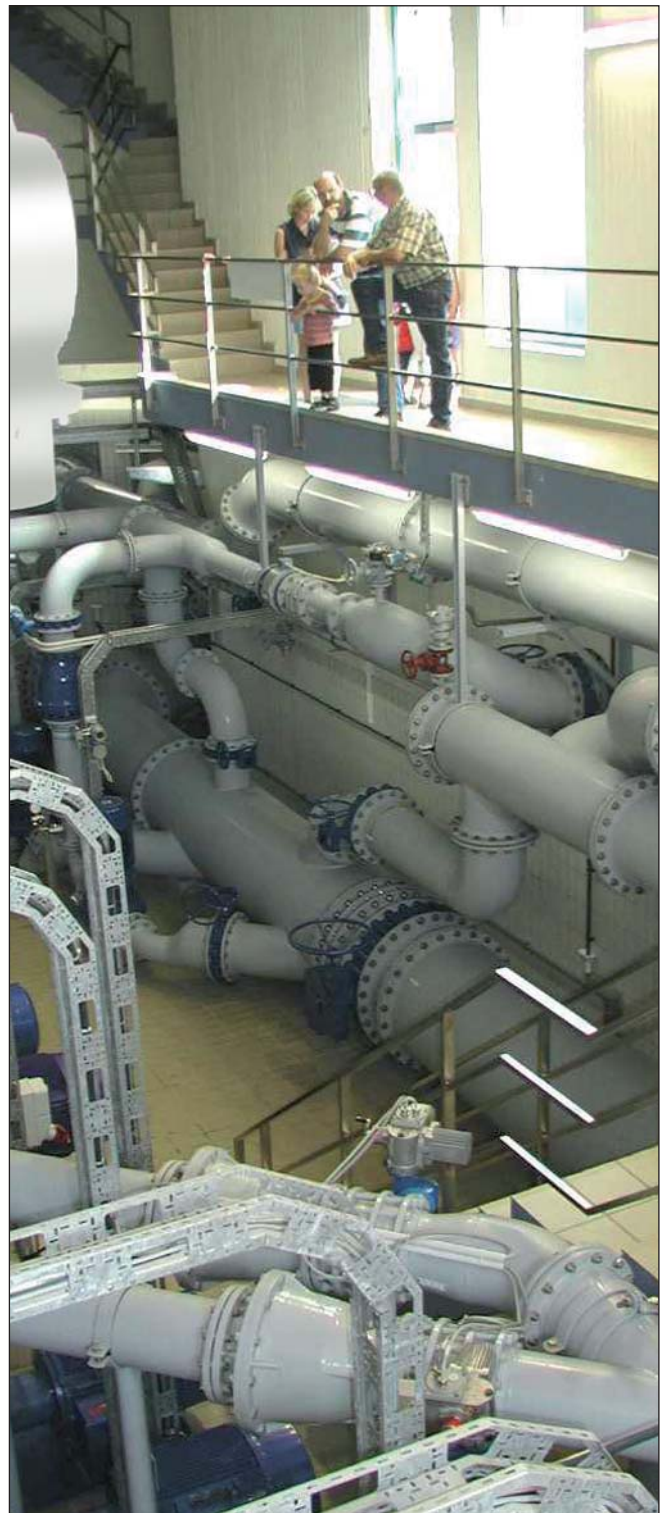
Einblick in das Pumpenhaus des Wasserwerkes in Bocholt-Liedern
