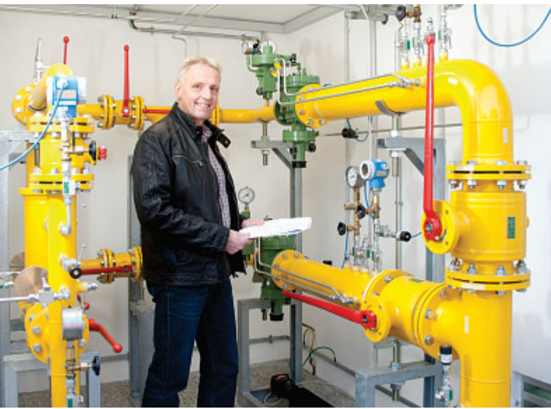
Die BEW investierte im Berichtsjahr unter anderem in eine neue Gasdruckregelanlage im Bocholter Ortsteil Suderwick.
