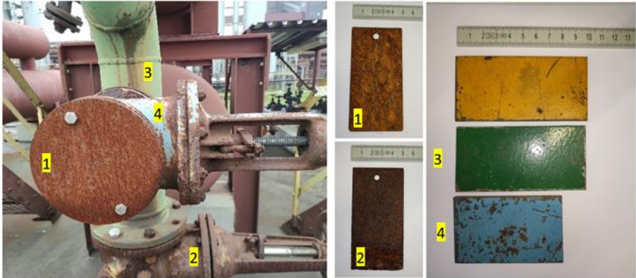
Abb. 4: Übertragung der identifizierten Korrosionsmechanismen, Kokerei Zollverein, Essen. @FZN / Christoph Meier.
