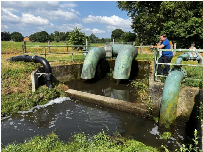
Abb. 3: Auslass der Druckwasserleitungen am Nullrand der Bergsenkung. © FZN/Tobias Rudolph
