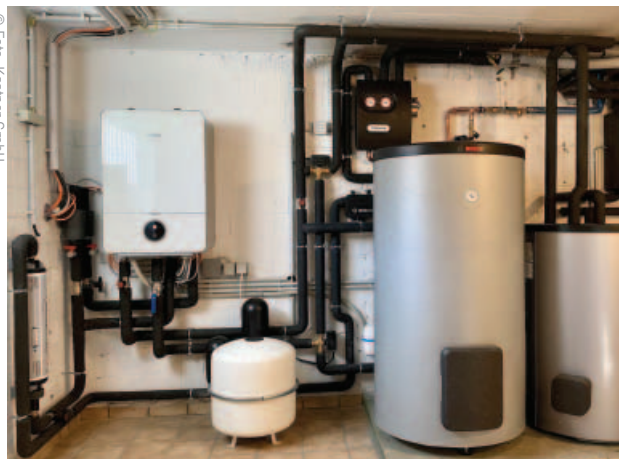
Wärmepumpen werden derzeit mit bis zu 35 Prozent der Investitionssumme gefördert
