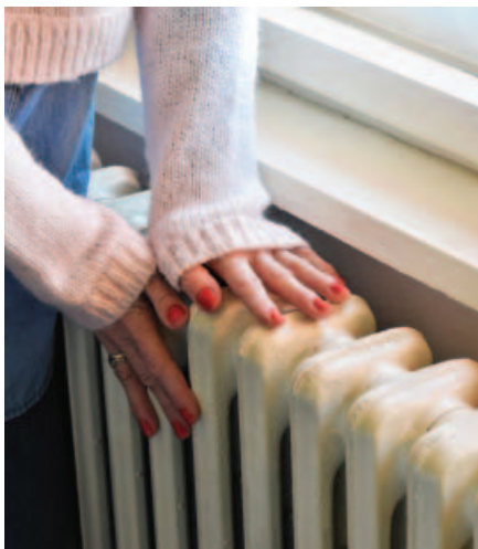
Der hydraulische Abgleich sorgt für eine gleichmäßige Wärmeverteilung.
