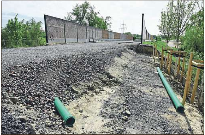
Rechts fehlt doch was, oder? Der Dammkörper der Ahlener Osttangente ist noch immer eine Baustelle, auf der nichts passiert. Foto: Ulrich Gösmann
