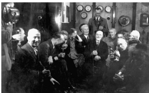
Der endgültige Abschied der Bahn vom Gleichstrom wurde 1951/52 gefeiert. Der Umformer ist bereits abgebaut. Im Hintergrund vor der nicht mehr benötigten alten Gleichstromschalttafel stehend Direktor Cebulla (Foto Stadtwerke Soest).
