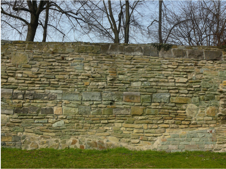
Abb. 1: Wahrscheinliche Spuren von Ausbesserungsarbeiten aus verschiedenen Epochen (Thomä-Grandweger-Wall). Foto: Verf.
