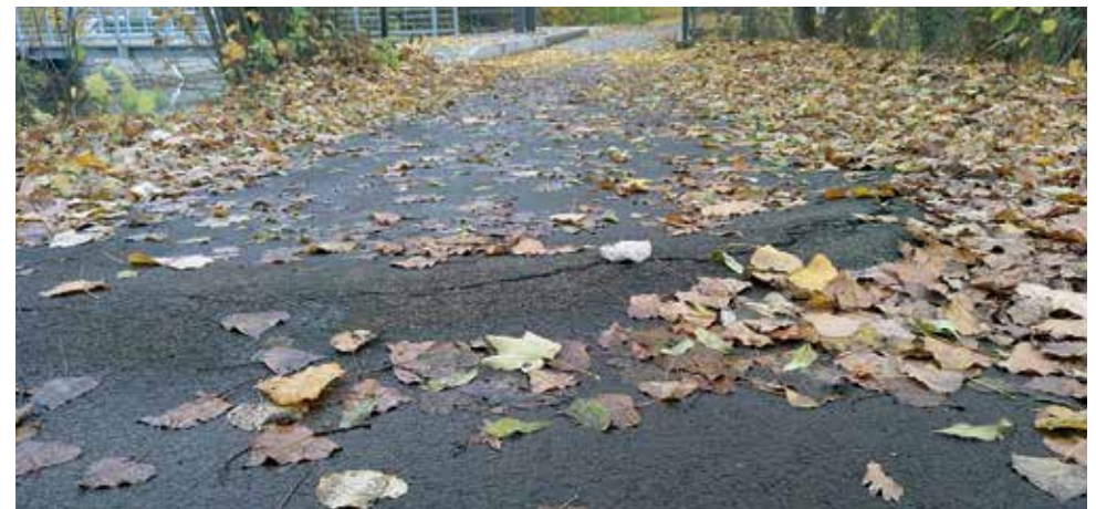
Fahrbahnaufbrüche und Laub – eine gefährliche Mischung
