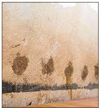
Nach dem Wasserschaden: Vor den Notmaßnahmen kommt das Beweisfoto. Foto: Andrea Warnecke/dpa-mag
