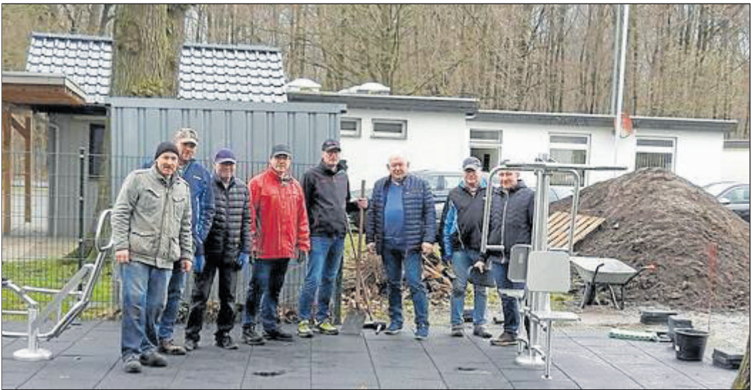
Jetzt kann es losgehen: Die Outdoor-Anlage ist fertig.
