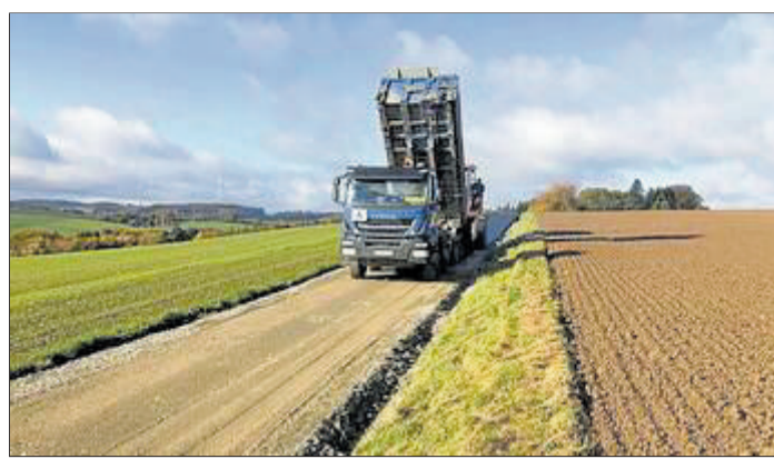
Sanierung der Wirtschaftswege in Kalletal: Der Asphaltbau erfolgt „Auf dem Windberge“ in Lüdenhausen. Foto: pr.
