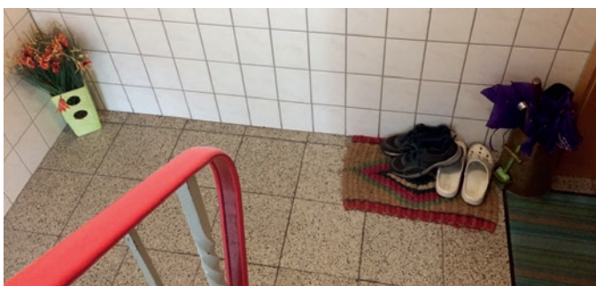
Schuhe in den Hausfluren können zu Brandherden und Stolperfallen werden.
