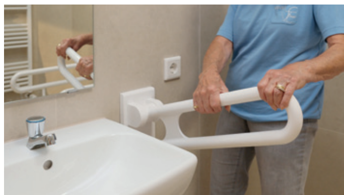
Stützklappgriffe geben zusätzliche Sicherheit im Badezimmer. Wohnberaterin Christiane von der Ruhr berät eine Ratsuchende im Rahmen eines Badezimmerumbaus.
