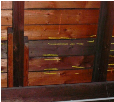
Fugenbildung zwischen Brettern lässt Wasser durch
