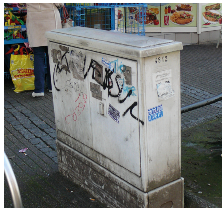
Stromkästen gestalten, S.24
