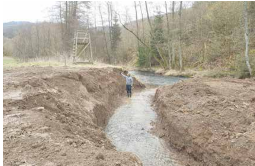
Abbildung 20: Hohe Uferabbruchkante im Verweigungsgerinne.
