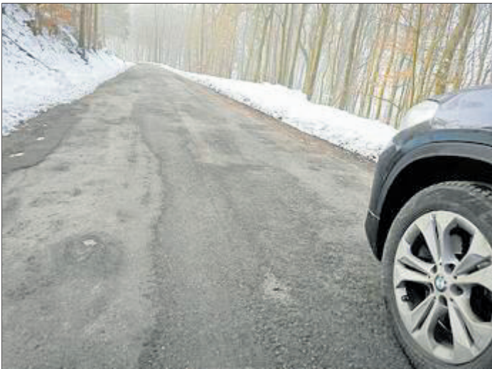
Die L962 zwischen Kalletal und Extertal ist in einem desolaten Zustand. Foto: M. Stoller
