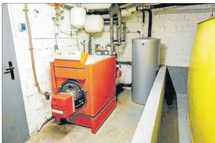
Funktionierende Heizkessel müssen nicht getauscht werden. Foto: DJD/Bauherren-Schutzbund/Daniel Beckemeier/stock.adobe.com
