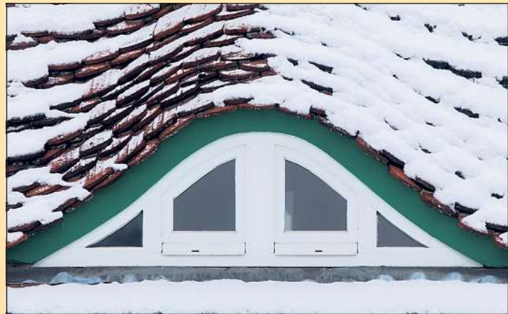
Erker und Gauben sehen an Häusern einladend aus. Aus energetischer Sicht sind sie aber nicht so vorteilhaft, da es an diesen Stellen zu einem Wärmeverlust kommen kann.
