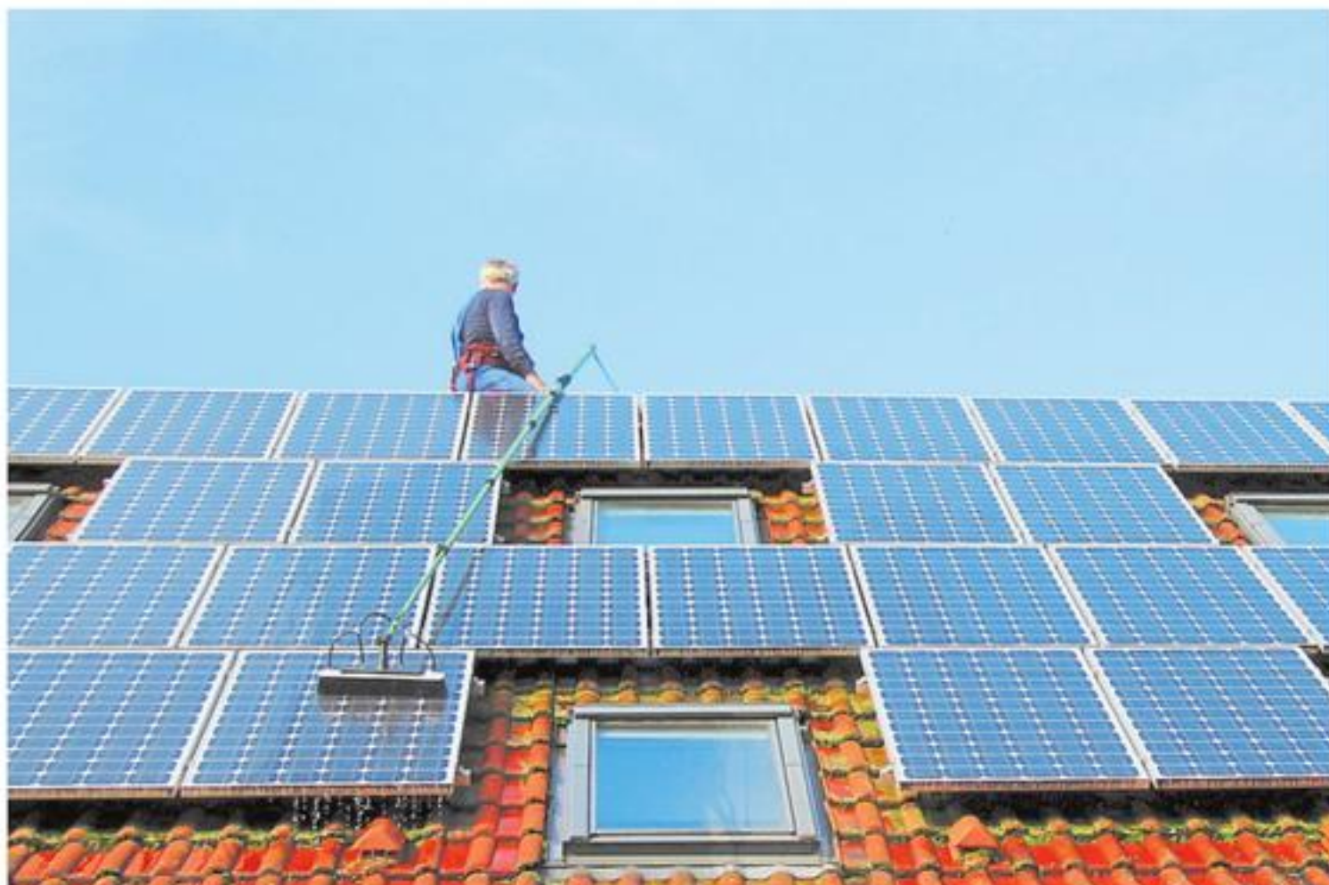
Die Überprüfung und Reinigung der Anlage sollte Fachleuten überlassen werden, rät das Informationsprogramm Zukunft Altbau.
