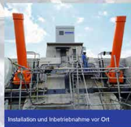
Elektrische Schaltschränke mit lokalen Steuerungssystemen
