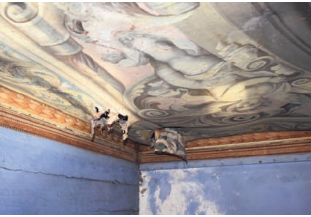
5 Starke Beschädigung der linken hinteren Bildecke mit großen Löchern in der Leinwand. Foto 2014.
