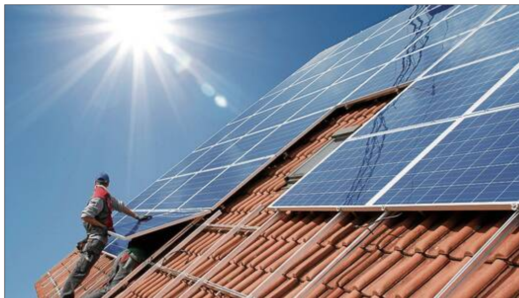
Wer Solarstrom auf dem Dach erzeugt und damit einen Großteil des Energiebedarfs selbst deckt, wird als Prosumer bezeichnet. Auf vier von potenziell elf Millionen geeigneter Häuser befindet sich bereits eine Solaranlage. Foto: DJD/LichtBlick/PantherMedia/Andreas Weber
