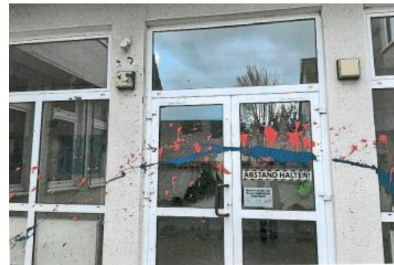
Farbschmierereien an der Grundschule.
