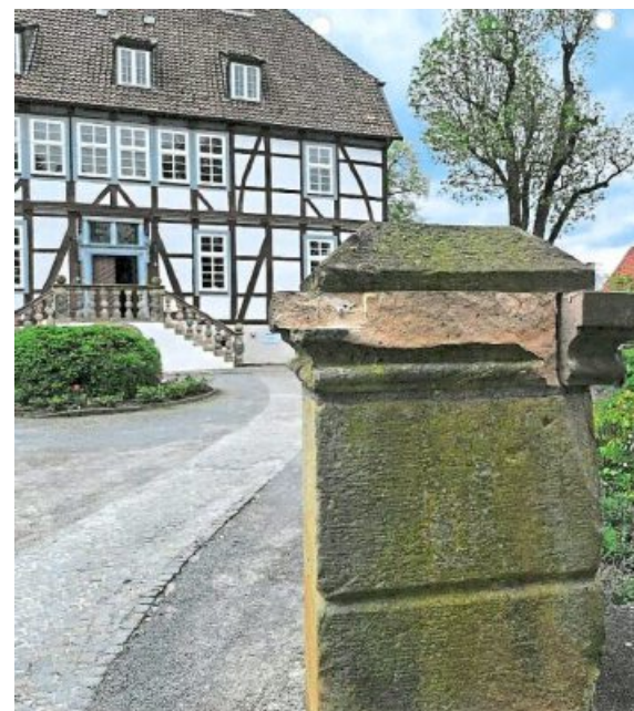
Zerstörter Sockel am Mallinckrodtthof.
