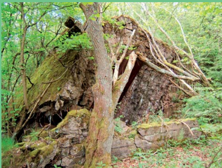
Ein stark zerstörter Bunker. Bei der Sprengung durch die Alliierten wurde die Decke stark entstellt. Diese Anlage bietet eine sehr hohe Strukturvielfalt. Foto: S. Schöne
