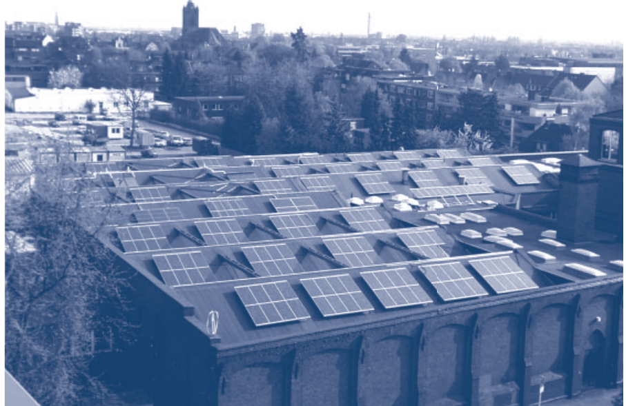
Hochschule Niederrhein, Abt. Mönchengladbach, Fotovoltaikanlage auf Spinnereigebäude
