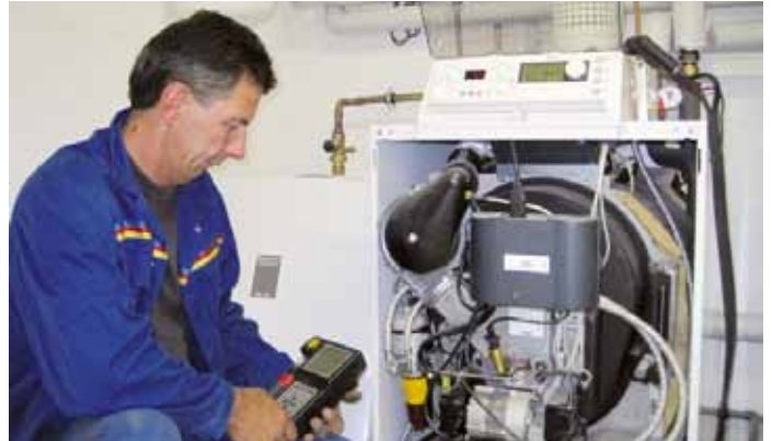
Mit einer regelmäßigen Wartung stellt die Firma Essing einen effizienten Energieverbrauch sicher, so sparen die Kunden Heizkosten und die Nutzungsdauer der Heizungsanlage wird verlängert.
