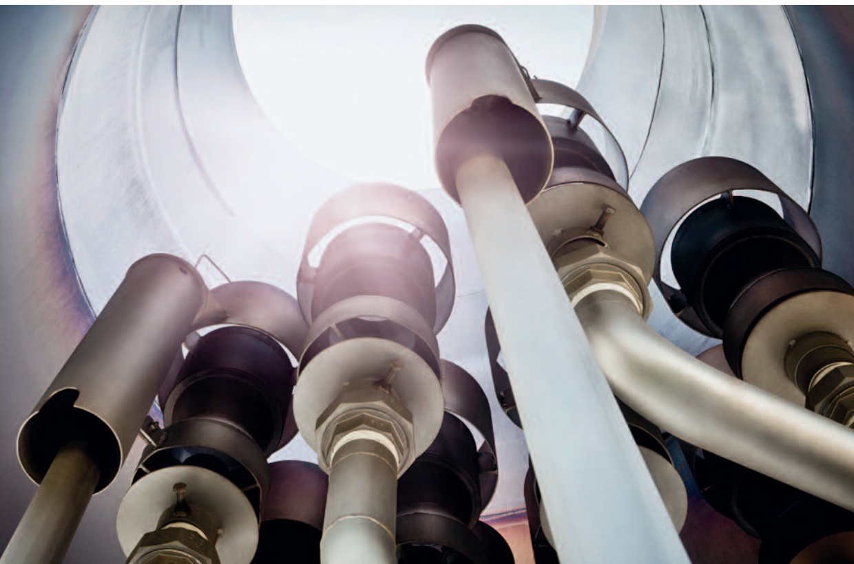
Arcanum Energie Biogasanlage – Biomethanfackel
