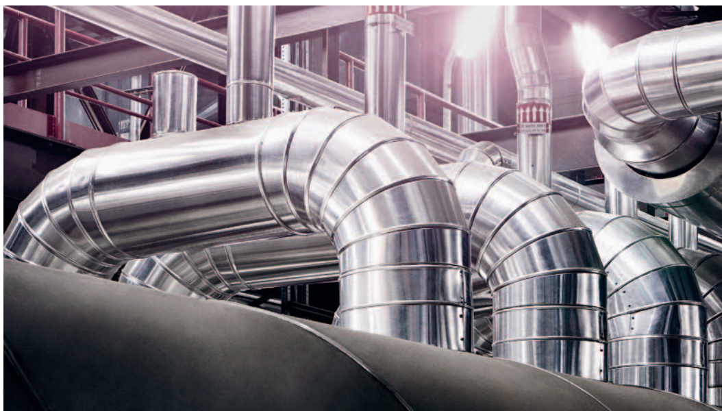
Trianel Gaskraftwerk Hamm – Kessel – Wasserdampf/Trenngefäß
