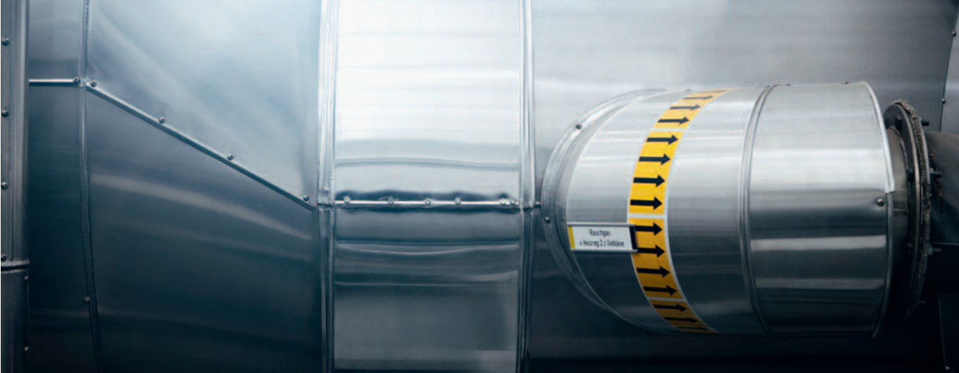
Trianel Gasspeicher Epe – Detail der Gastrocknungsanlage
