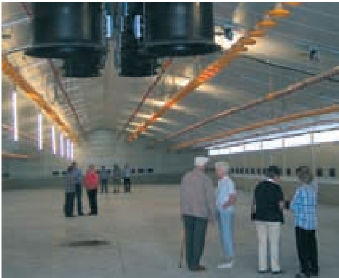
Viel Technik wurde in der 110 mal 18 Meter großen Halle verbaut. Die Abluft wird über die schwarzen Zylinder nach draußen geleitet. Noch hängen Tränken (rot) und Futterbehälter (gelb) unter der Decke. Wenn eingestallt wurde, werden diese elektrisch herunter gefahren.
