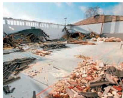
Viel ist bereits beseitigt, aber einige Trümmerreste liegen immer noch inmitten der eingestürzten Halle.
