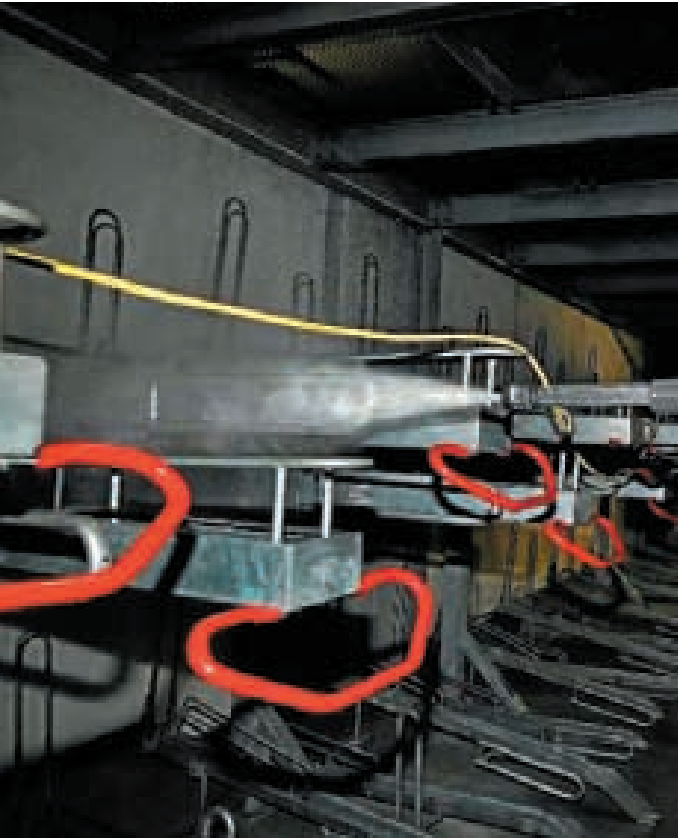
Die Spuren des Brandes im Fahrradparkhaus an der Stubengasse sind überall noch deutlich zu sehen. Foto Konietzny
