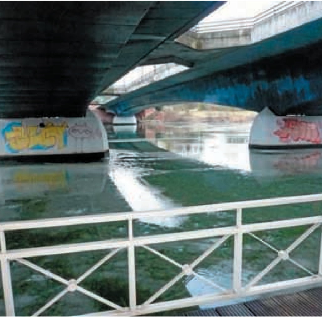
Die Brückenpfeiler können nur mit erheblichem Aufwand gereinigt werden.
