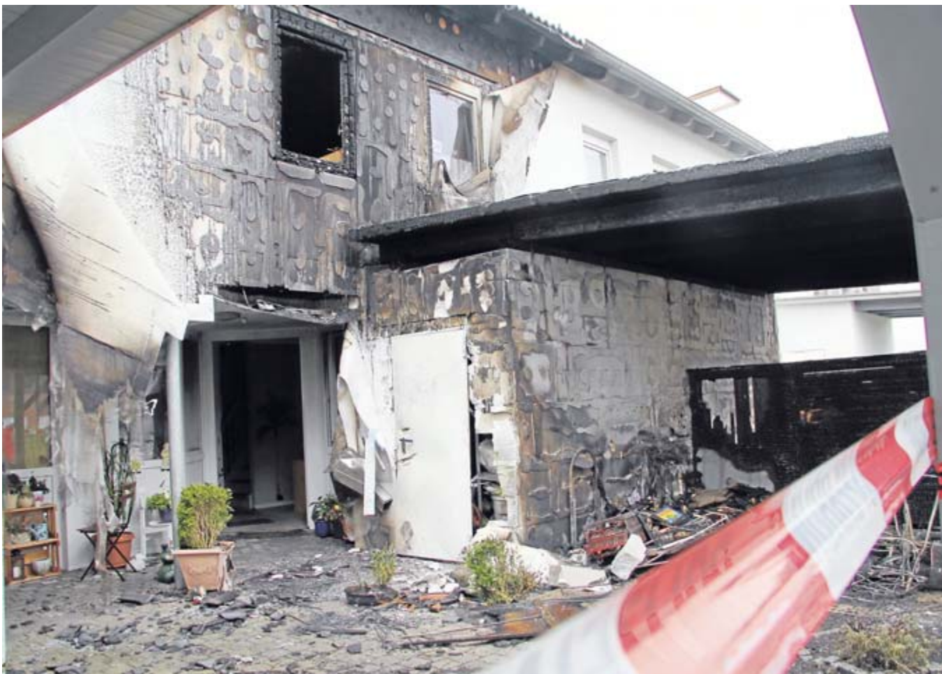
Dieses Haus in Münster-Albachten ist nach dem verheerenden Brand nicht mehr bewohnbar.
