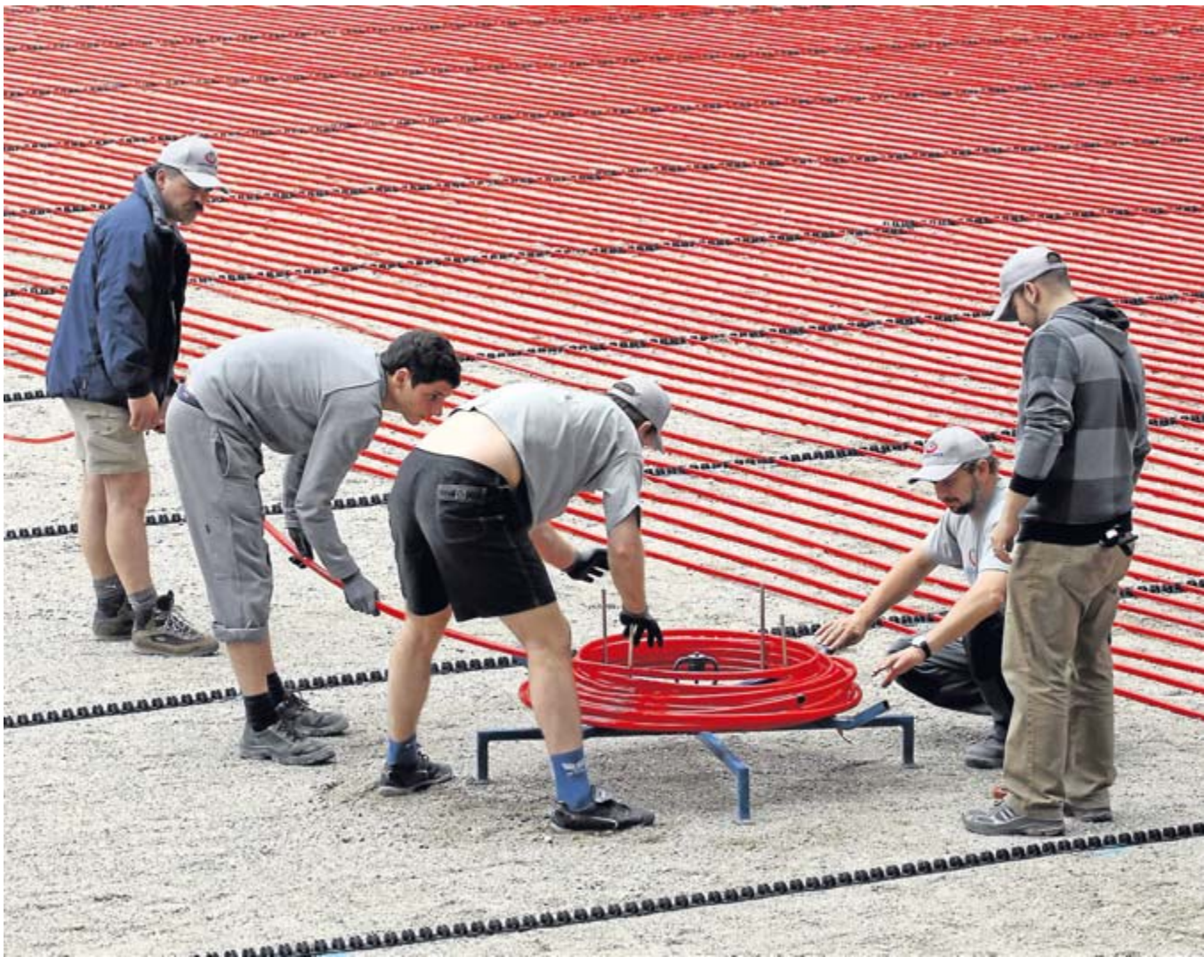
Durch ein kilometerlanges Rohrsystem wird bei Rasenheizungen das rund 40 Grad warme Wasser befördert.
