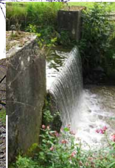
Vorher nicht zu überwinden
