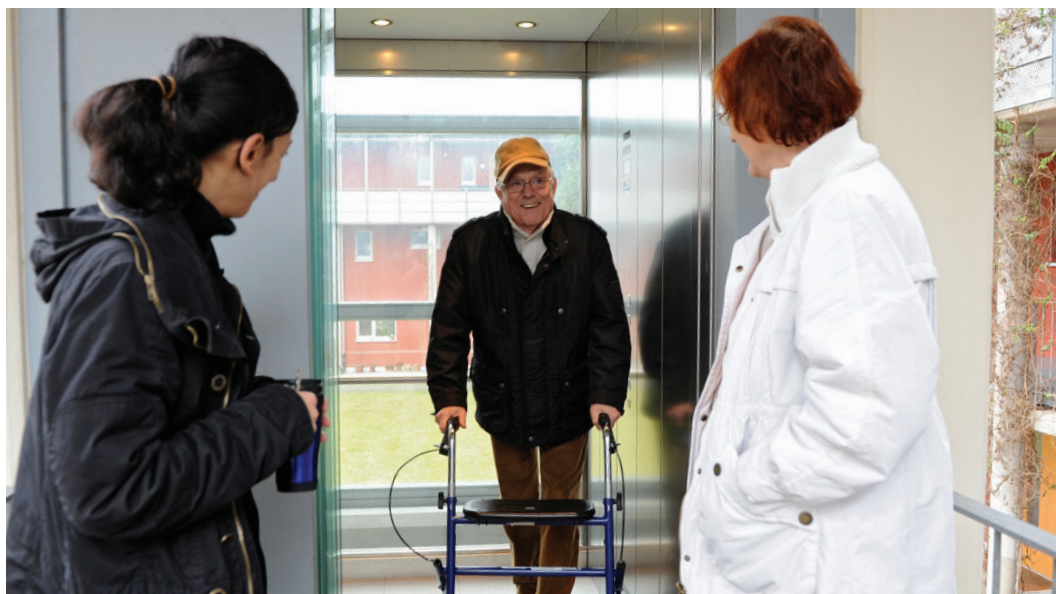
Barrierefreie Erschließung einer Wohnanlage durch Aufzüge
