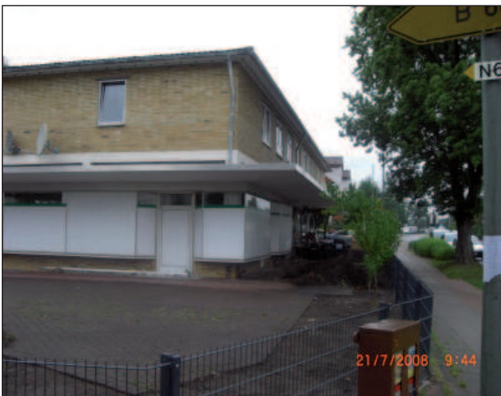
Gestaltungsmängel bei umgenutzten Ladenlokalen (Versammlungsraum)
