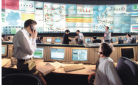
„Gipfel der Betriebsüberwachung“: Das ganze Netz auf einen Blick. Genau 68 Quadratmeter groß ist die Monitorwand des neuen Net Management Center der Deutschen Telekom in Bamberg. Hier überwachen und steuern Telekom-Spezialisten 24 Stunden am Tag und sieben Tage in der Woche die Fernverbindungen im T-Net. Foto: Deutsche Telekom
