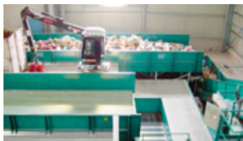
Der Schubboden der Sortier- und Aufbereitungsanlage von BRT.
