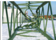
... umgeknickten Strommasten war das Westmünsterland nach dem Schneechaos Ende November.
