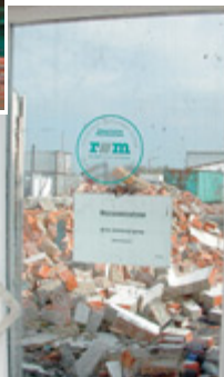
Waren werden hier nicht mehr angenommen: Hinter der unversehrten Glaslür türmen sich die Trümmer der Produktionshalle.
