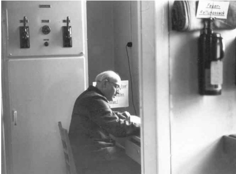
Vermittlungsstelle Ziegelstraße. In einem kleinen Nebenraum des Wählersaales stand die Stromversorgung (die Batterien befanden sich im Keller). Hier hatte Albert Rühnbrink seinen Platz. Er gehörte zu Fernsprechentörungsstelle und war "ausgelastet" mit Schaltungen am Hauptverteiler und hatte täglich 2x die Säuredichte der Batterie zu messen.
