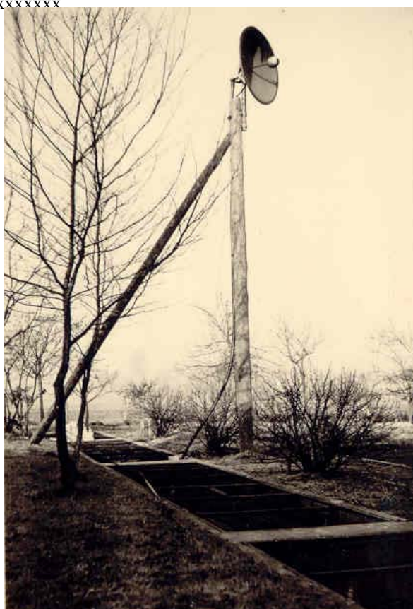
Verstärkeramt Wiedenbrück (St. Viet) im März 1952. Parabolspiegelantenne (1,20 m Durchmesser) für PPM 24/2500.
