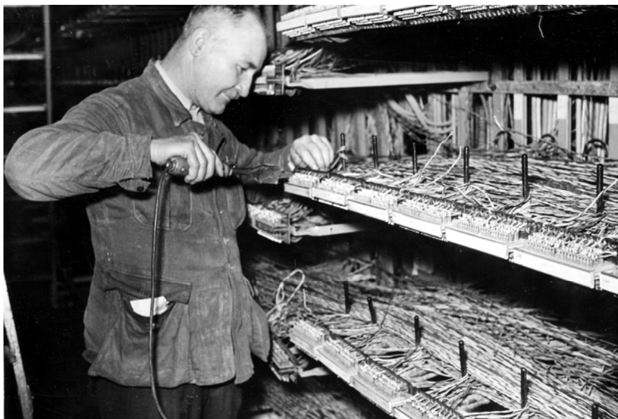
Schaltarbeiten am Hauptverteiler in Bielefeld-Mitte um 1950.
