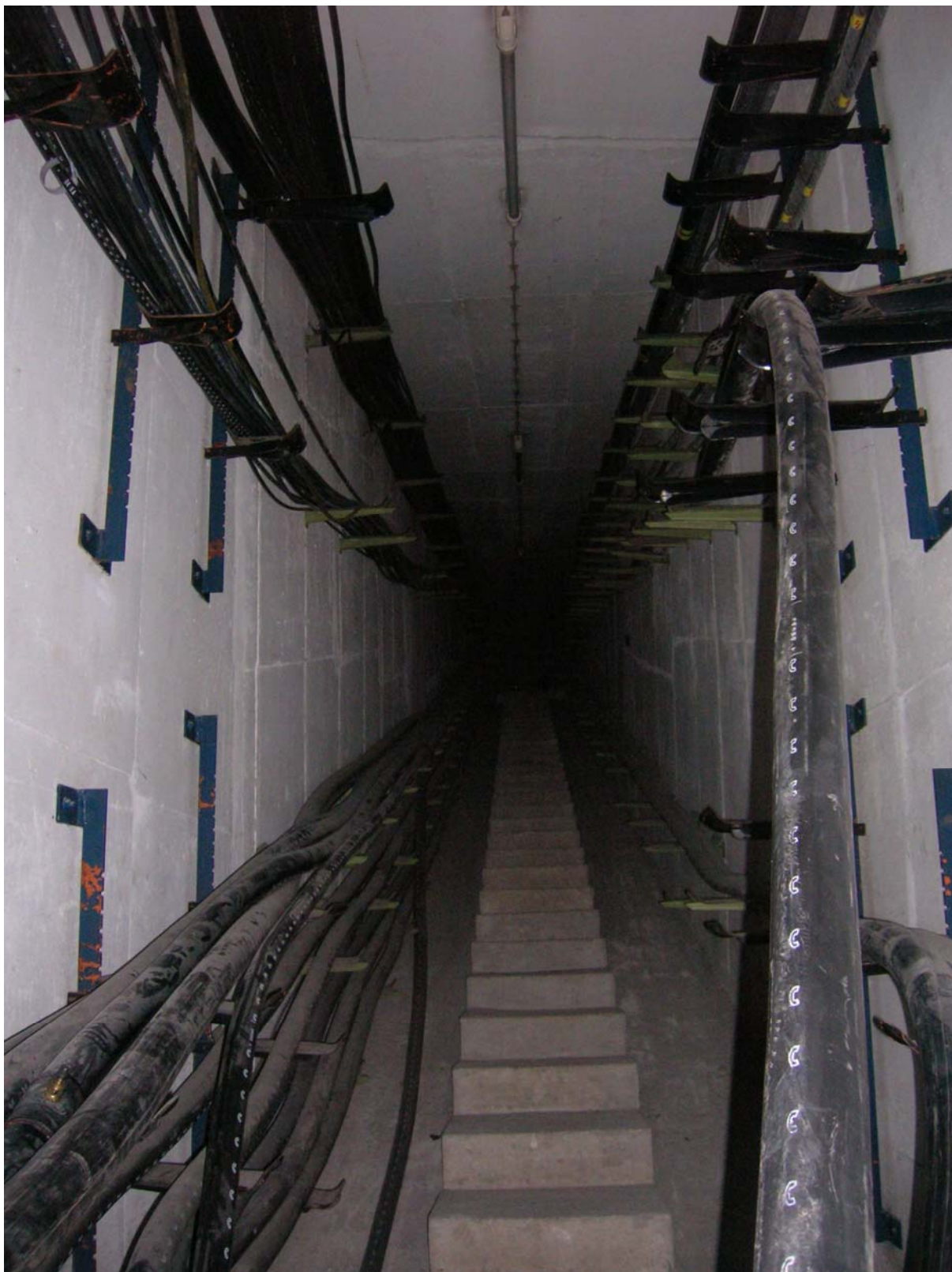
Aufnahme vom 06. Juli 2006 im Kabelaufteilungskeller Bielefeld Mitte. Kabelzuführung vom Einführungsschacht in den Kabelaufteilungskeller.
