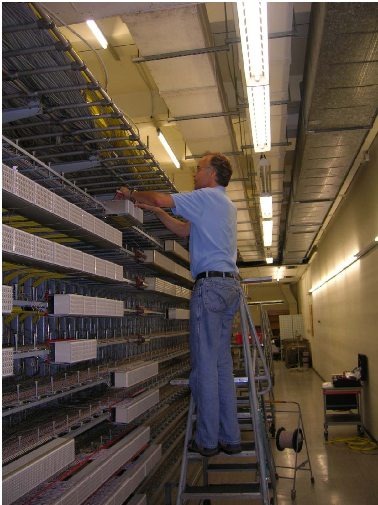
Günther Hartke bei Schaltarbeiten am Hauptverteiler Bielefeld Mitte. Waagerechte Seite. Aufnahme vom 06. Juli 2006.
