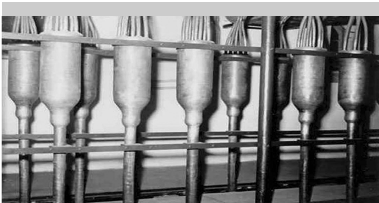
Standmuffen im Kabelkeller einer Vermittlungsstelle.
