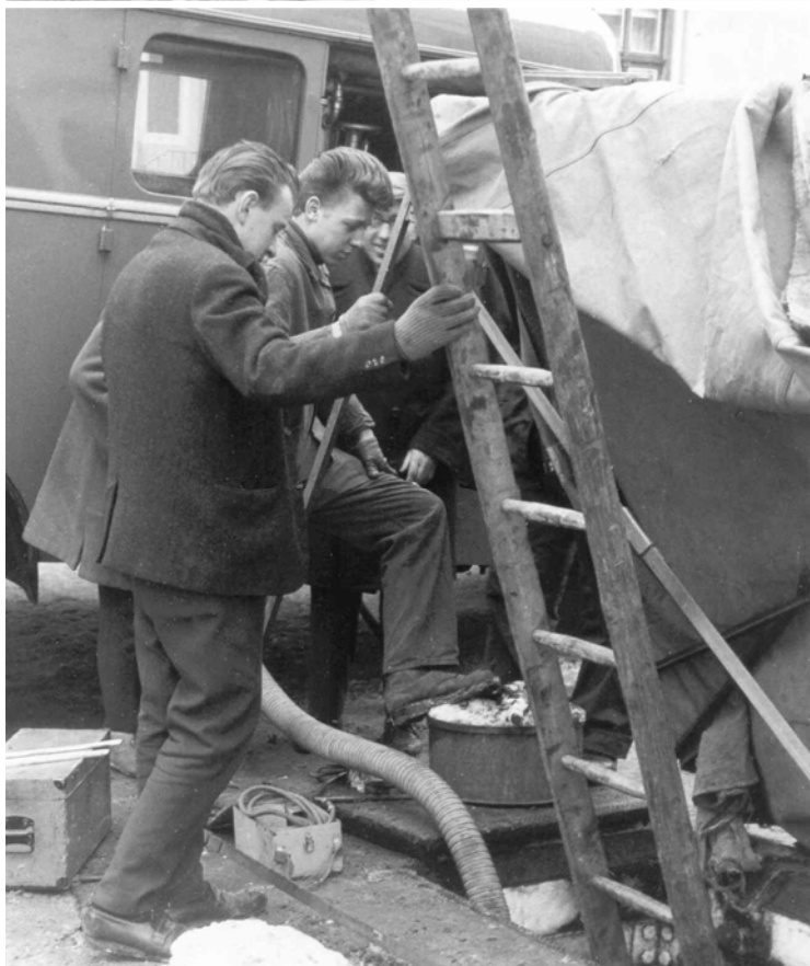
22. Januar 1963. Wasserrohrbruch, Kabelschächte stehen unter Wasser.
