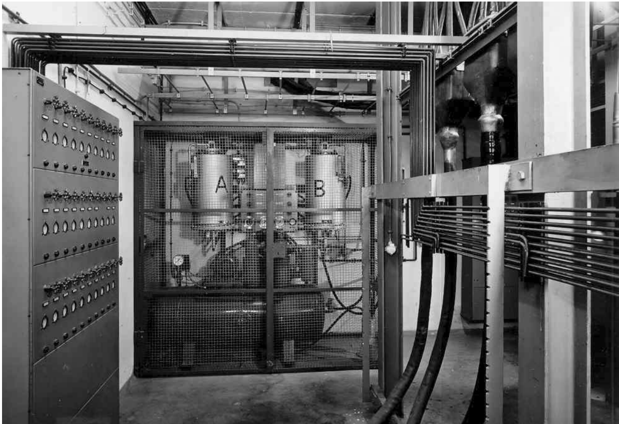
Stationäre Druckluftprüf- und Trocknungsanlage für eingeführte Kabel der Firma Maschinenbau Hafenhütte Peter Lancier, Münster, im Kabelauteilungsraum im Kellergeschoss einer Vermittlungsstelle. In der Mitte der Kompressor, links die Manometer für die Kabel, rechts die Druckleitungen, die zu den Kabeln führen.
