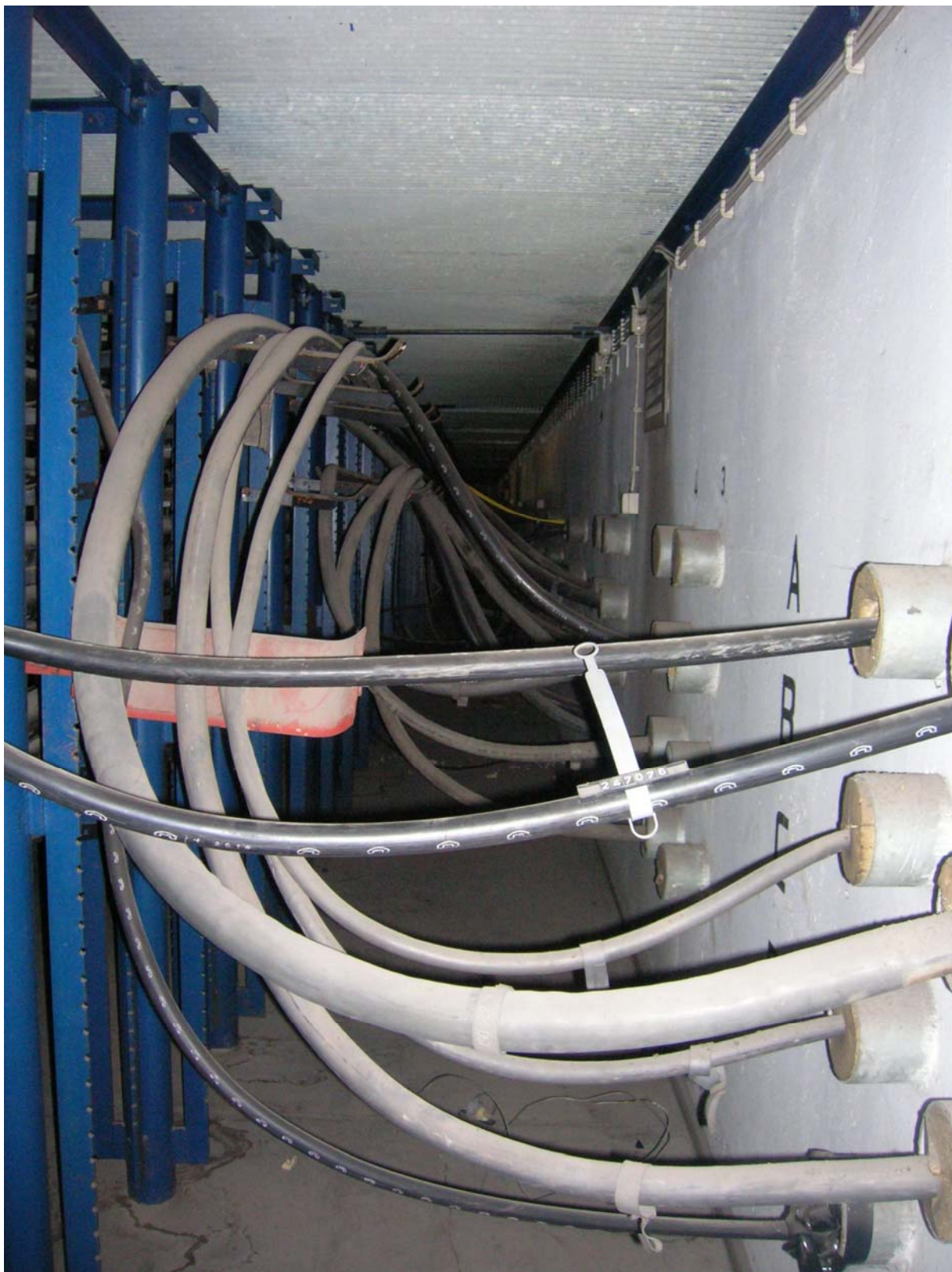
Aufnahme vom 06. Juli 2006. Kabelaufteilungskeller Bielefeld Mitte.
