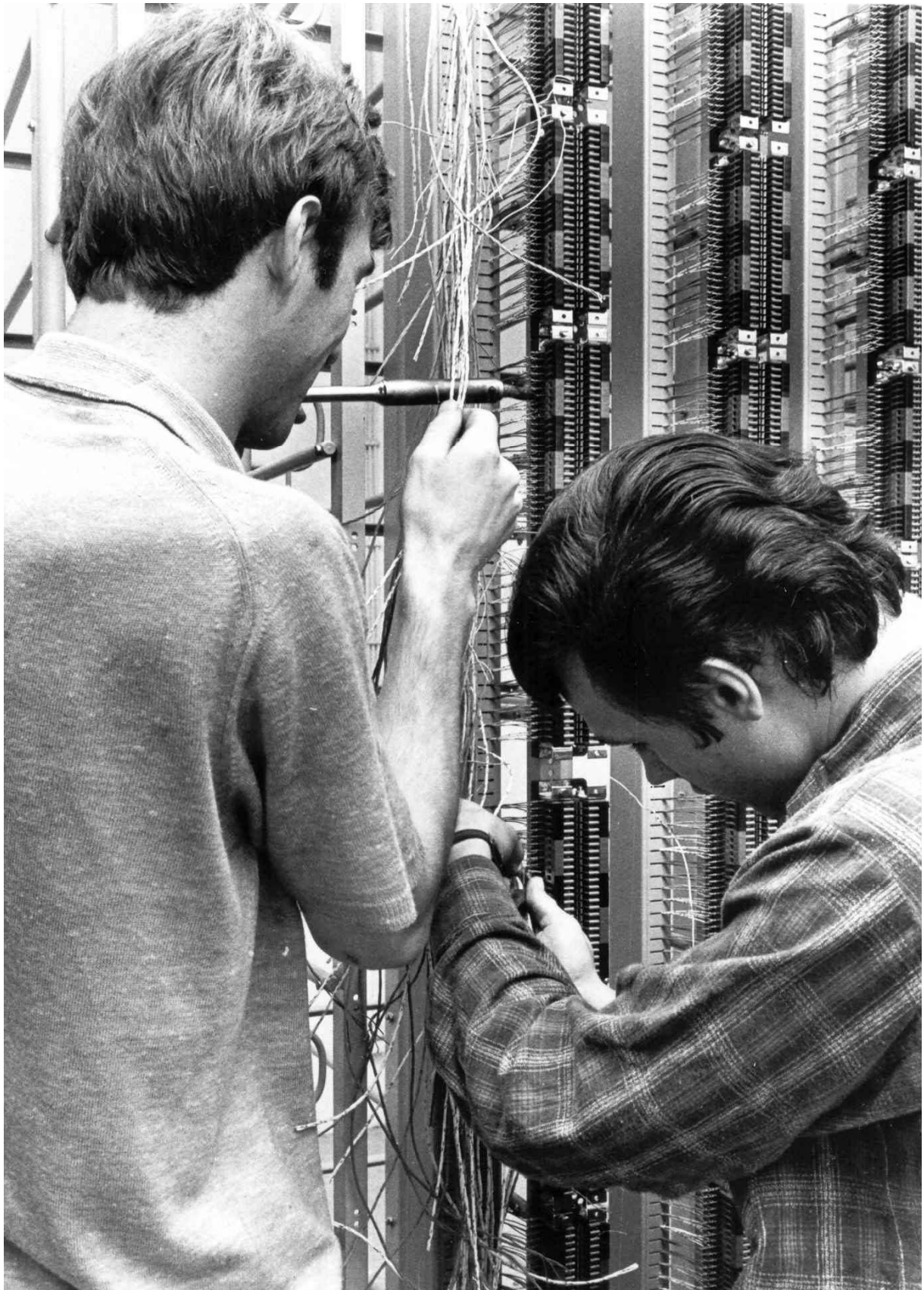
Aufbau des Hauptverteilers im neu gebauten Technik-Trakt in Bielefeld Ende 1970/Anfang 1971. Rechts Bernd Sielemann.
