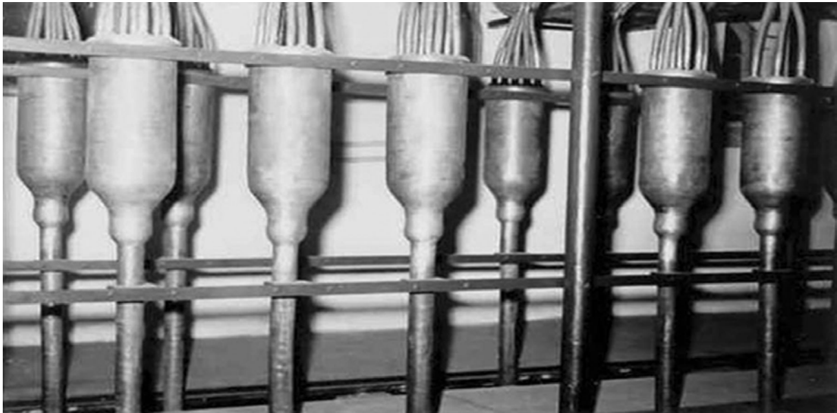
Standmuffen im Kabeleinführungskeller einer Vermittlungsstelle.
