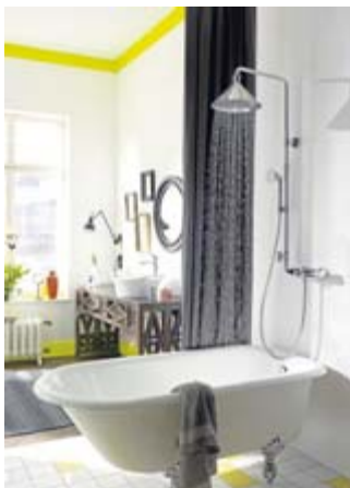
Bei dieser Duschinstallation sind die Versorgungsleitungen deutlich sichtbar. Foto Axor
