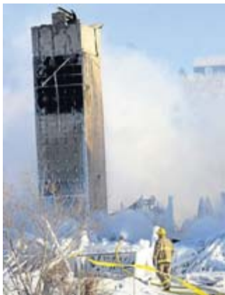
Nur der Fahrstuhlsschacht blieb stehen. Foto AFP
