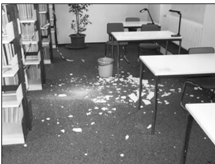
Deckenputz, von Feuchtigkeit unterwandert, machte sich selbständig in der Bibliothek.
