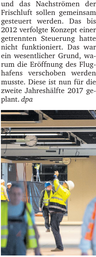
Die Entrauchungssteuerung des neuen Hauptstadtflughafens soll inzwischen unter Kontrolle sein.
