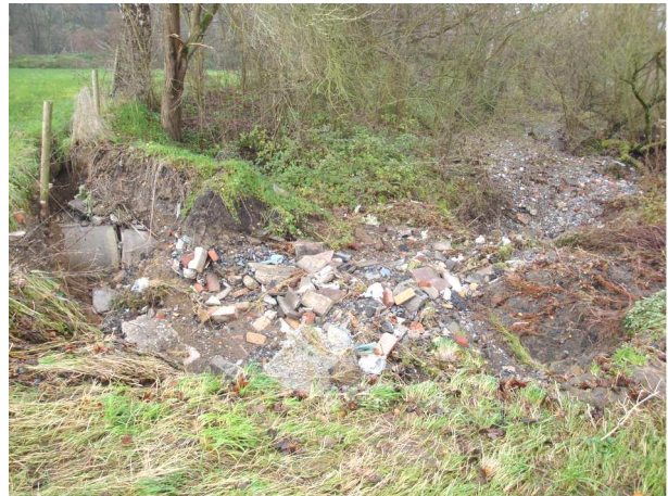
Foto 68: Erosion im Bereich der alten Kläranlage
