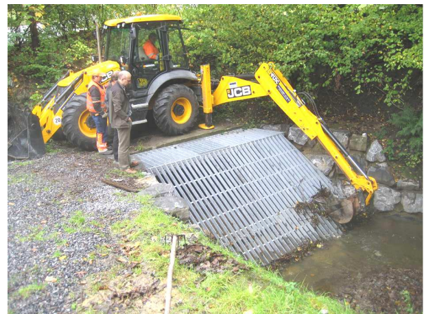
Foto 86: Neues Durchlassgitter Frielingsen
